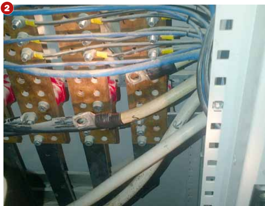
Barre di rame nei quadri elettrici
